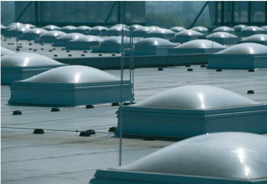
Bild 8: Lichtkuppeln zur Beleuchtung einer Halle.
