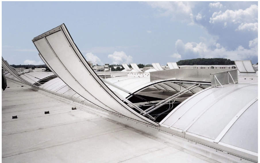
In Dachlichtern integrierte Rauchabzugsgeräte erfüllen die Anforderungen der Brandschutzbehörden.
