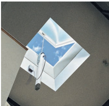
Bild 4. Lichtkuppel mit RWA im oberen Treppenraum
