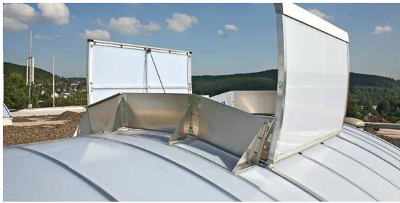
Dachlichtband mit geöffnetem NRWG
