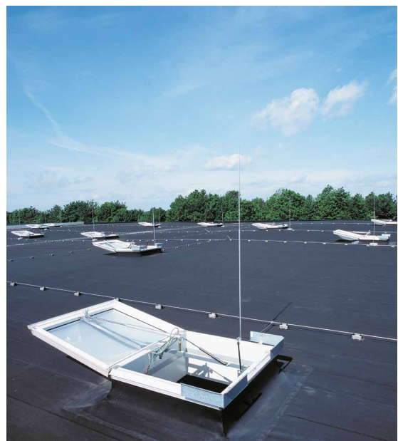
Im Dach eingebautes, qualifiziertes, natürliches Rauchabzugsgerät NRWG
