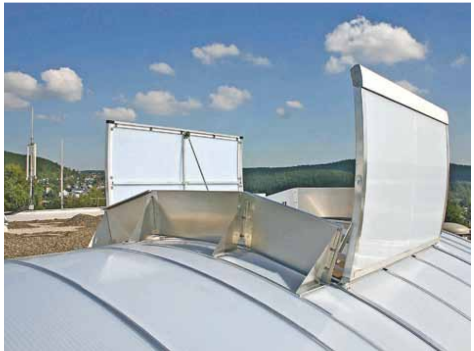
Bei Einsatz von natürlich wirkenden Rauch- und Wärme-Abzugsgeräten (NRWG) sollte etwa pro 200 m 2 Grundfläche mindestens ein NRW eingebaut werden.
