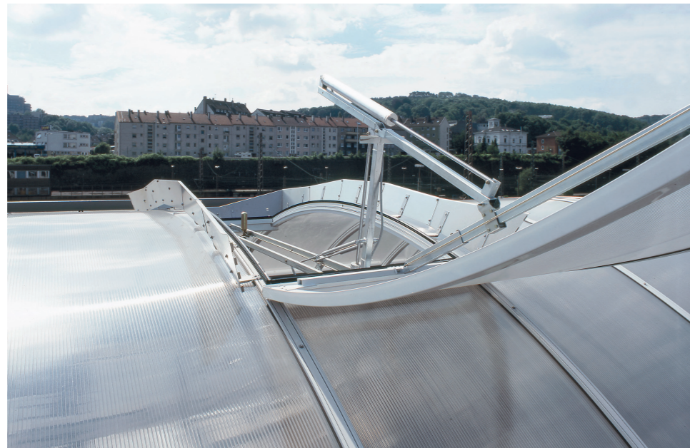
In Lichtkuppeln oder Lichtbandsegmente integrierte NRA müssen im Brandfall öffnen, um Rauch und Wärme abzuleiten.
