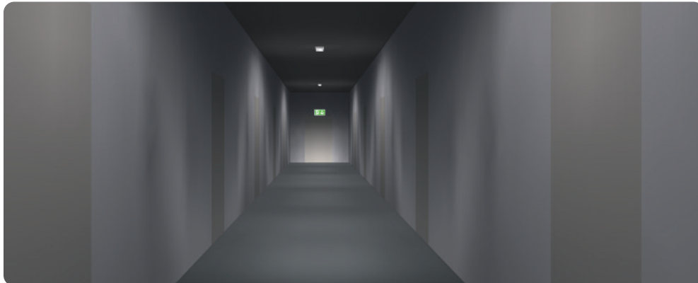
Abbildung 5.3.1: Beleuchtung von Flucht- und Rettungswegen. Beherbergungsstätten, Garagen, Versammlungsstätten, Verkaufsstätten, Hochhäuser, Schulen und Arbeitsstätten sind typische Anwendungsfälle.
