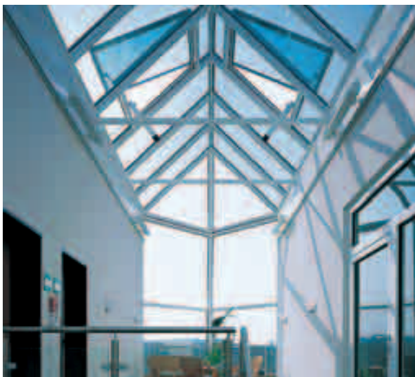
Dachoberlichter sorgen für eine natürliche Beleuchtung. Das spart im Vergleich zur künstlichen Beleuchtung Energie und Kosten. Fotos: FVLR
