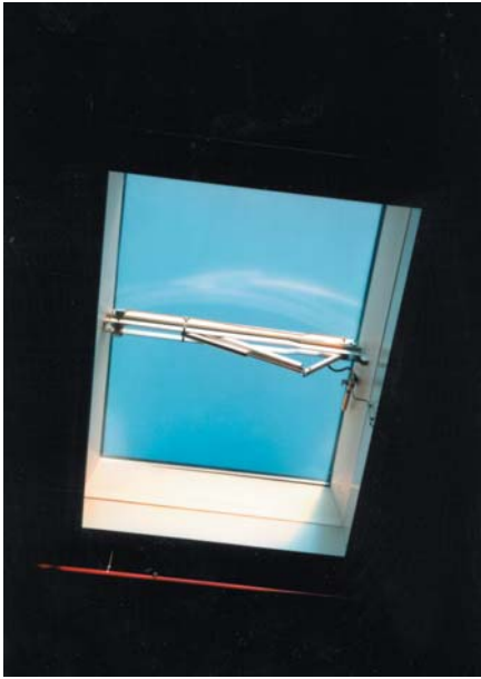
Natürliche Rauch- und Wärmeabzugsanlagen bilden einen wichtigen Baustein in modernen Brandschutzkonzepten.
