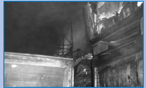
Ein Innenangriff war wegen fehlender RWA nicht möglich.
