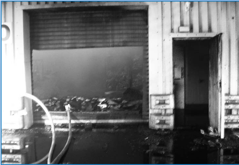
Völlig ausgebrannt: Die Feuerwehr konnte bei diesem Brand nur noch das Übergreifen auf die anderen Brandabschnitte und benachbarte Gebäude verhindern.
