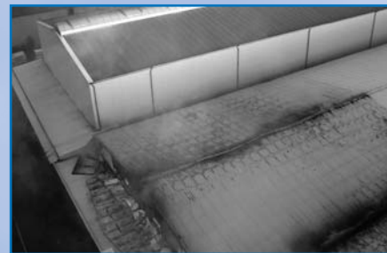
Aufgrund fehlender RWA stürzte das Dach teilweise ein.
