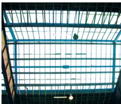
Zeit, Wetter und Abgase hatten dem Dachoberlicht von 1937 zugesetzt.
