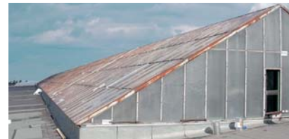
Sanierungsbedürftig: das alte Dach.
